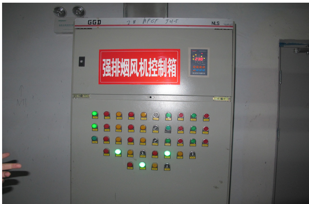
地下车库强排风机控制箱
