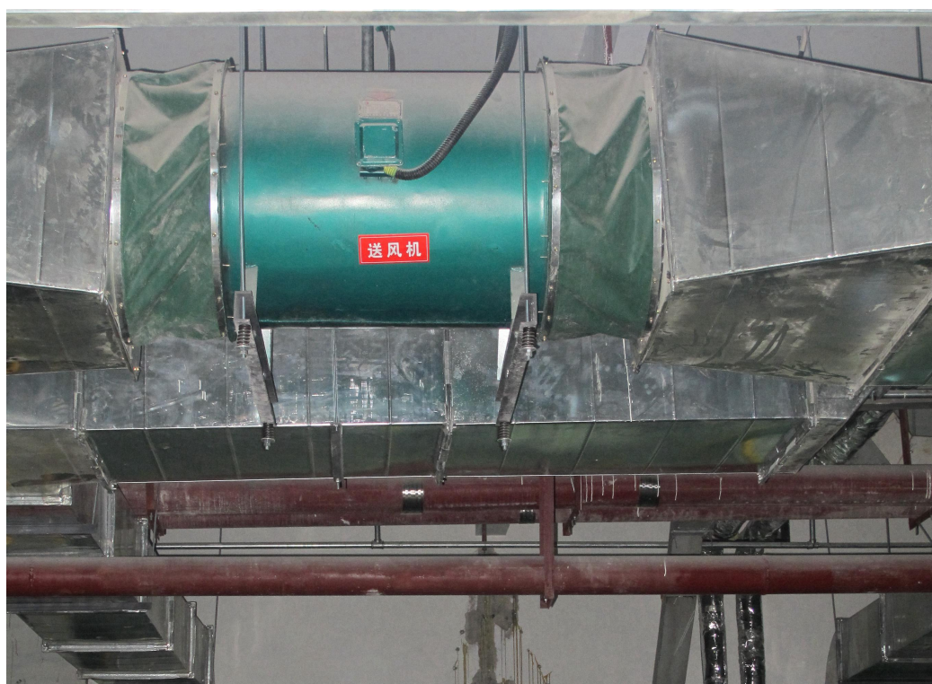
地下车库的机械排放系统（送风机）
